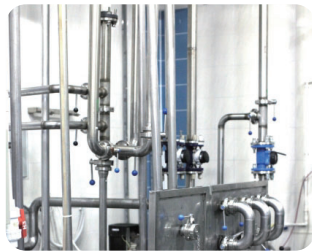
ダンパー、バルブコントロール
